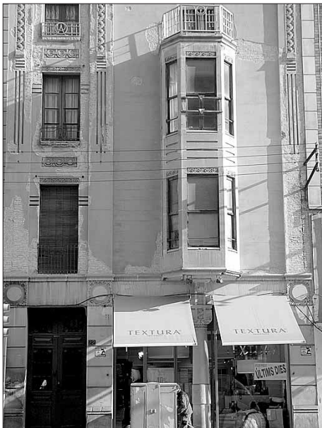
La fachada del edificio está muy deteriorada
