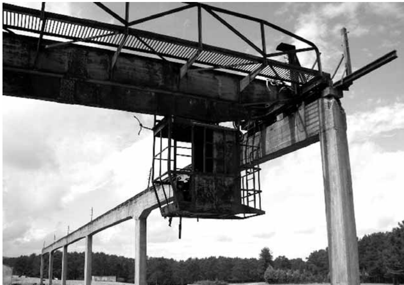
Grúa de las instalaciones de carga de madera en el apeadero de Pinar Grande. GUILLERMO FERNÁNDEZ/SM.NET
